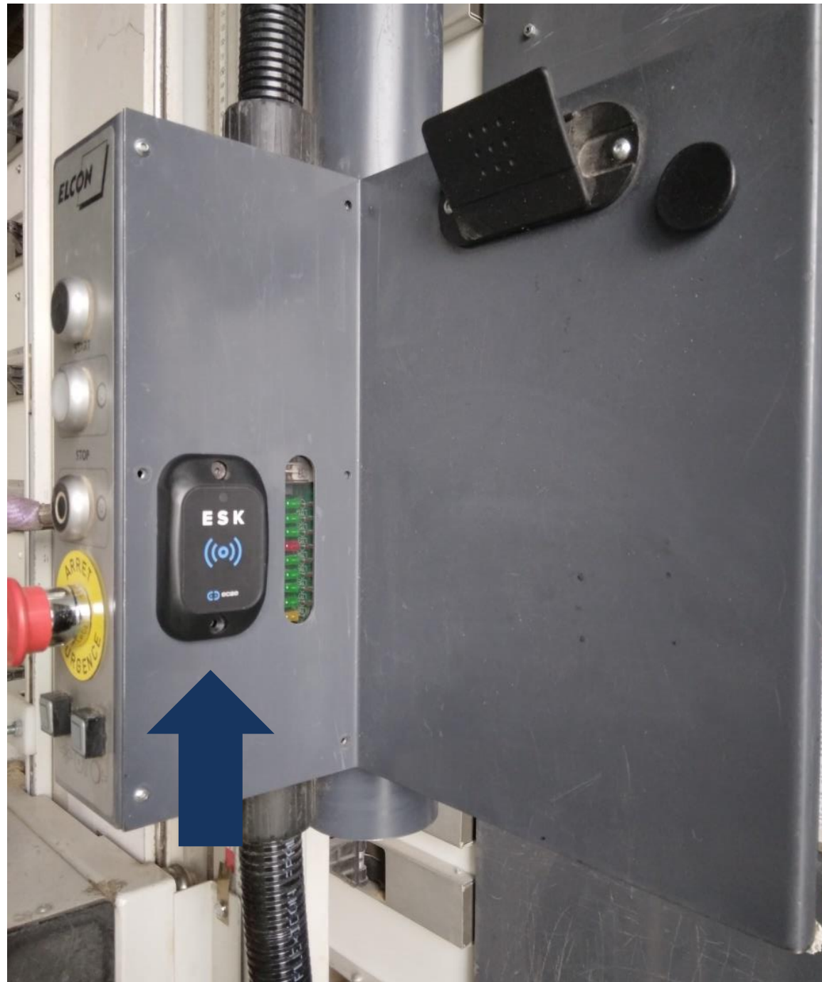
Lecteur de badge installé en façade de la scie pour l'identification de l'utilisateur.
